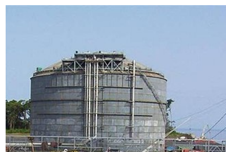
LNG storage tank at EG LNG
